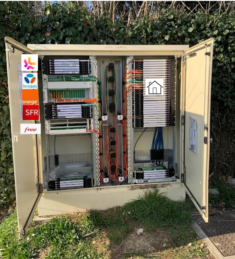
Armoire mise en service
